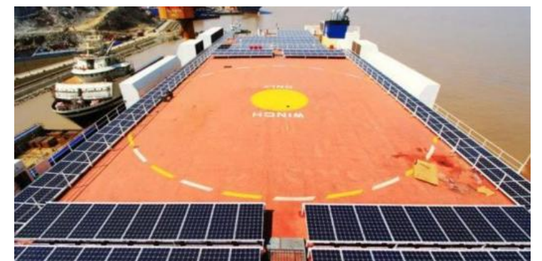
2021年集团在大型滚装船上应用太阳能技术，安装143.1KW的太阳能光伏系统，将太阳能转化为电能，提供船舶照明电源
